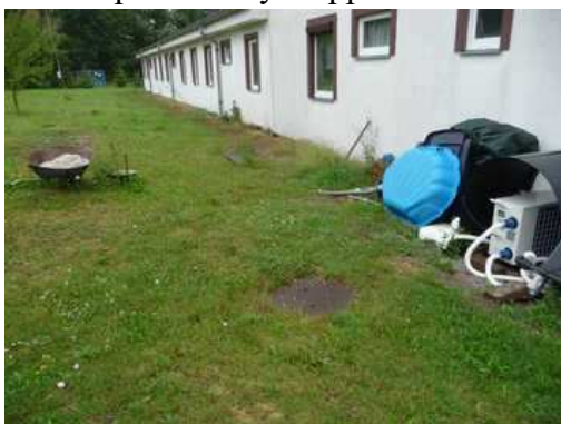
septik a kanalizace z čp. 26
